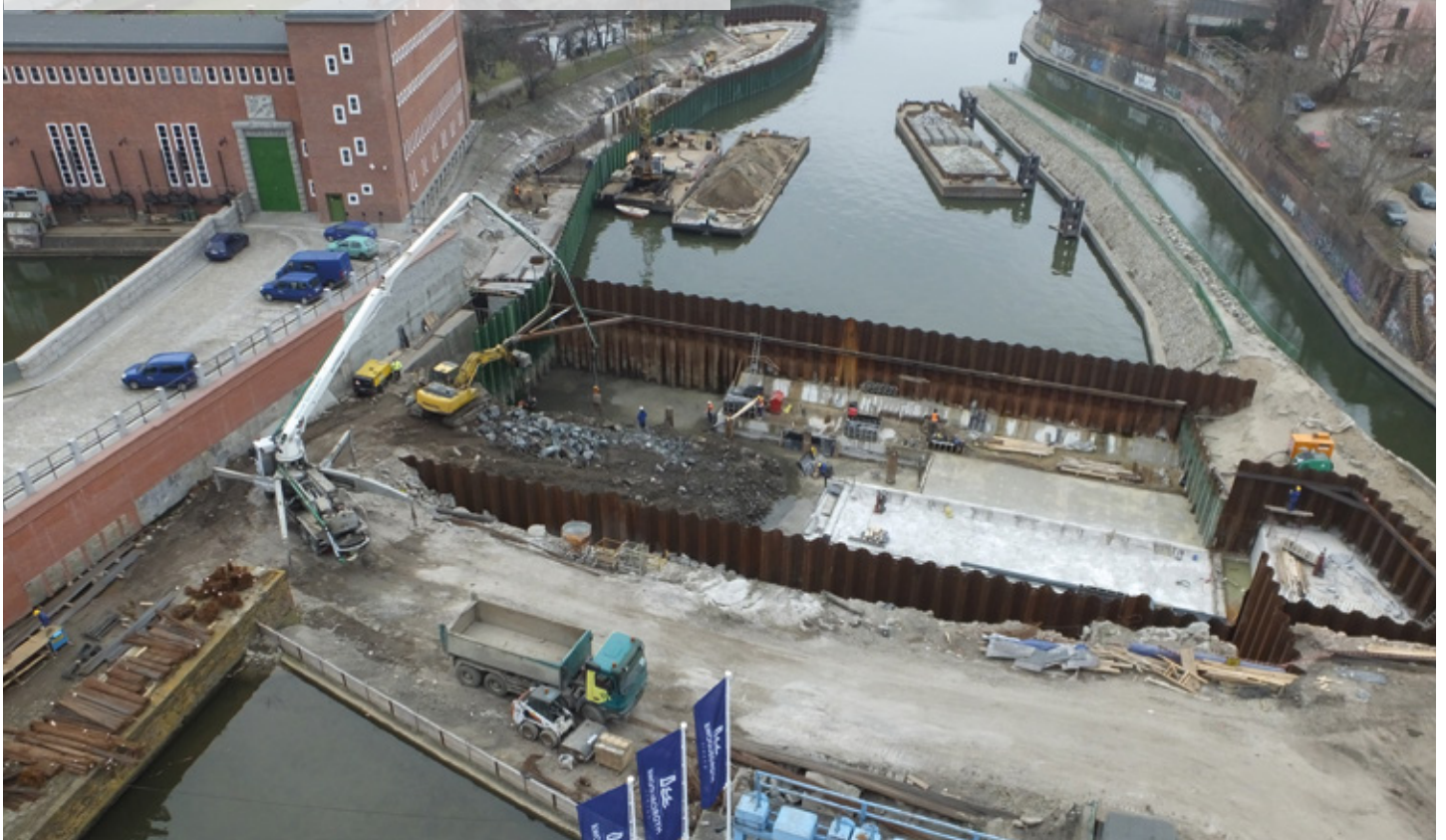
Sistema de protección contra inundaciones de Breslavia, Polonia
